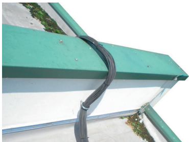
Abb 4.8.2: Ungeschützte Kabelführung über eine Brandwand, Quelle: VGH Versicherungen
