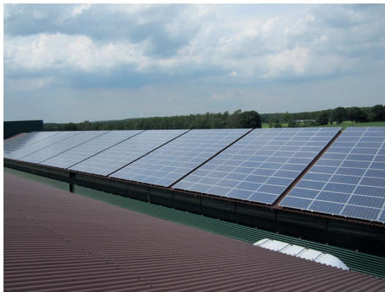
Abb 4.8.5: Generatoren auf Teilflächen aufgeteilt, Quelle: VGH Versicherungen
