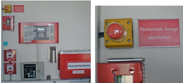
Abb 4.8.10: Zentrale Abschaltung, Quelle: VGH Versicherungen
