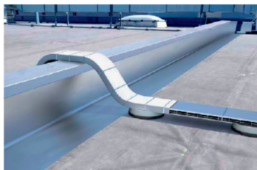
Abb 4.8.3: Geschützte Kabelführung über eine Brandwand, Quelle: OBO Bettermann
