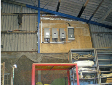
Abb 4.8.14: Unzugängliche Wechselrichter, Quelle: VGH Versicherungen
