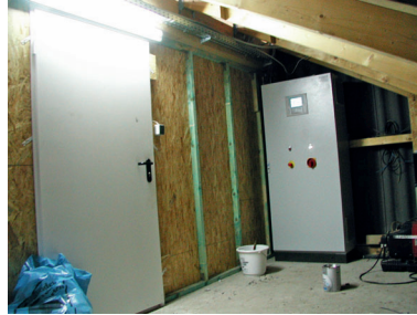
Abb 4.8.15: Unbelüfteter Betriebsraum des Wechselrichters, Quelle: VGH Versicherungen
