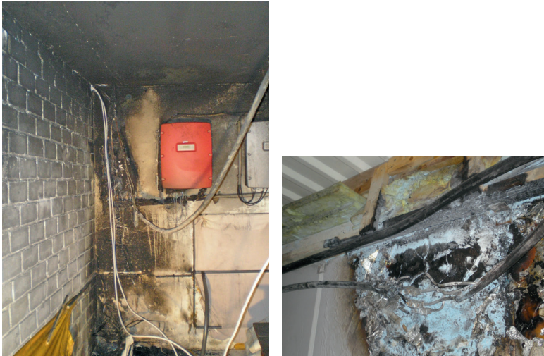
Abb 4.8.1: Brandschäden verursacht durch PV-Anlagen, Quelle: VGH Versicherungen
