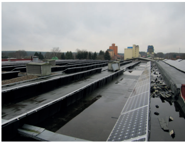
Abb 4.8.6: Überbaute Fangeinrichtung, Quelle: VGH Versicherungen
