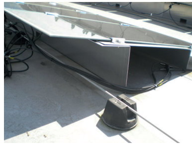
Abb 4.8.7: Demontierte Fangeinrichtung, Quelle: VGH Versicherungen
