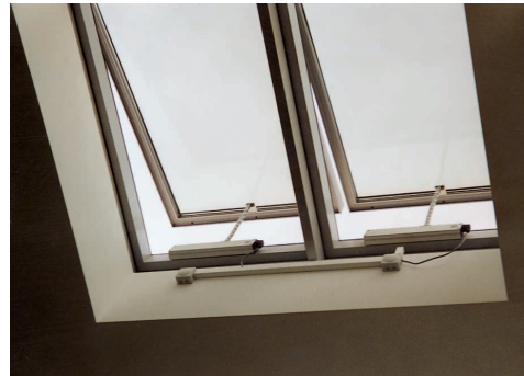
Abb. 4.6.5/25: Beispiel einer automatischen Treppenhaus-Entrauchungsanlage. Da Rauch nach oben steigt, wird das Treppenhaus weiter passierbar bleiben (Quelle: Scelsi)
