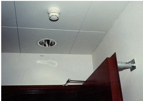
Abb. 4.6.5/24: Auch das Aufkeilen von Brand- oder Rauchschutztüren ist ein Verstoß gegen den §145 StGB; Abhilfe schafft eine Feststellvorrichtung, die im Brandfall automatisch schließt
