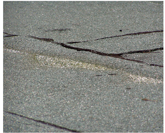
Abb. 11.2: Absenkungen in der Oberlage weisen auf Probleme hin.
