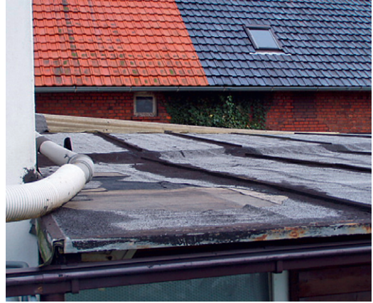
Abb. 10.3: Auch in diesem Fall wurden die Lagen mit Kaltkleber verbunden. Allerdings reichte weder die Menge noch die Qualität der Bahnen aus, dem Windsog standzuhalten.
