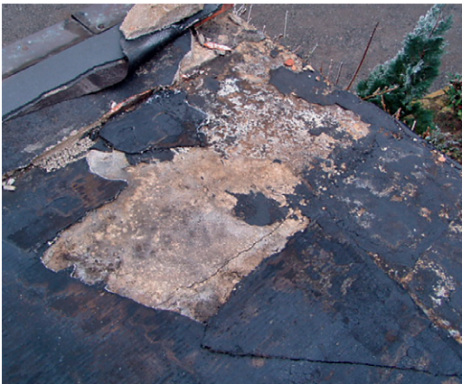
Abb. 10.1: Mangelhafter Voranstrich auf der Rohbetondecke
