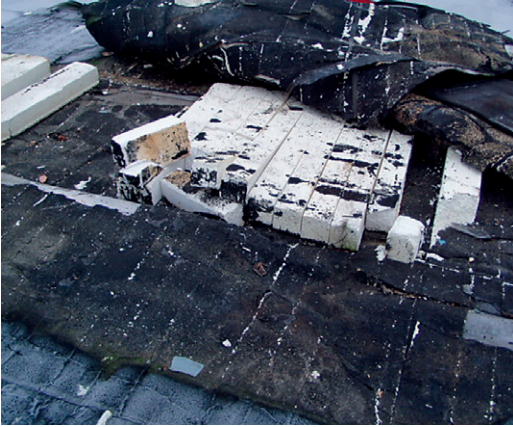
Abb. 10.2: Hier wurde eine völlig unzureichende Menge Kaltkleber verwendet.
