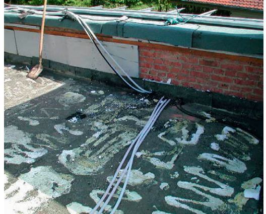
Abb. 10.5: Deutlich erkennbar ist der aufgeschäumte PUR-Kleber.
