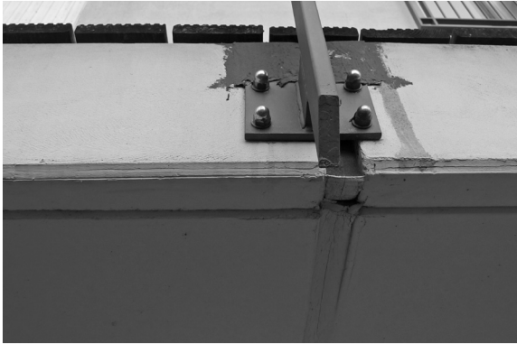
Abb. 6.2: Tatsachenbefund: Verschraubung der Geländerfußplatte beidseitig einer Bauteilfuge
