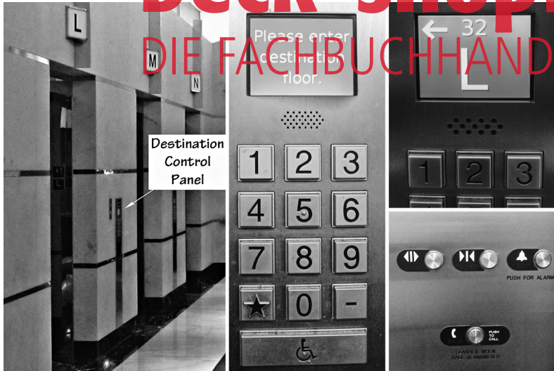
ABBILDUNG 4.8 Zielwahlgesteuerte Aufzüge. Bei einem zielwahlgesteuerten System wird die gewünschte Etage außerhalb des Aufzugs in ein Tastenfeld eingegeben (A und B). Nachdem die gewünschte Etage eingegeben wurde (B), zeigt das Display dem Passagier an, welchen Aufzug dieser nehmen sollte. Wie in C, wo „32“ eingegeben und dem Passagier per Anzeige Aufzug „L“ vorgeschlagen wurde (der erste Aufzug auf der linken Seite auf Bild A). Es gibt keinerlei Möglichkeiten, die Etage im Inneren des Aufzugs zu wählen. Im Inneren befinden sich nur Knöpfe für das Öffnen oder Schließen der Türen und der Alarm (D). Es handelt sich hierbei um ein sehr viel effizienteres Design, das aber verwirrend für diejenigen ist, die an das konventionellere System gewöhnt sind. (Fotografiert vom Autor)
