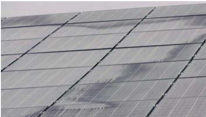
Abb. 3.4.22/1: Photovoltaikfläche mit einem kleinen gereinigten Bereich (Quelle: B & W Solar Solutions)
